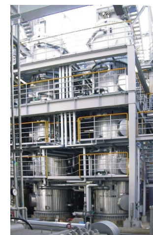
クロマト分離設備
