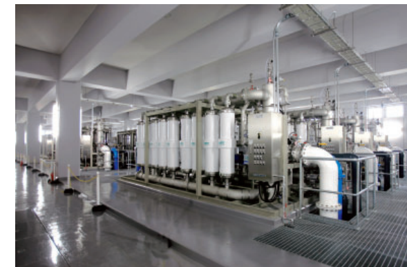
江山浄水場膜ろ過ユニット
